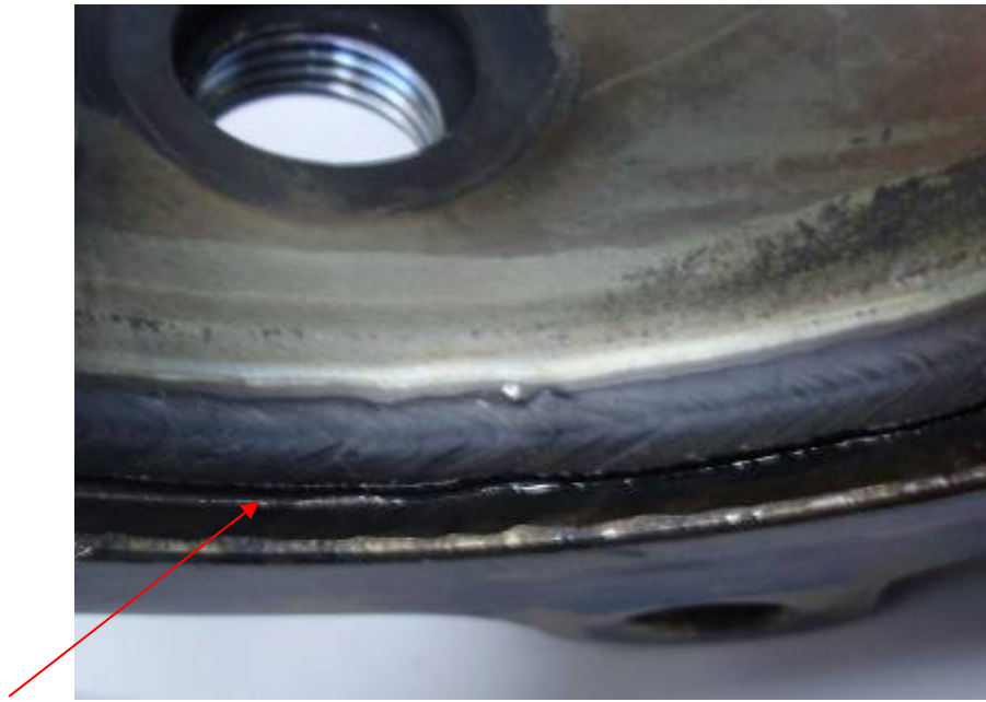
Фото 12. Сварной шов в месте начала разрушения (стрелкой указана кольцевая трещина).
